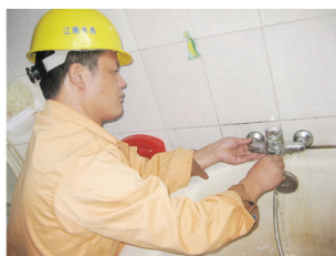
义务检修用水设施
